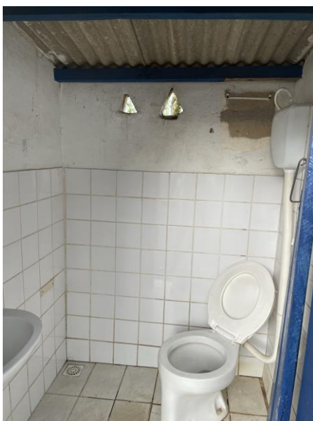
FOTOS 35 e 36: Ambientes 17 e 18: anexo da Casa Sede. Depósitos escuros, desprendimento de camada pictórica e rachaduras na parte posterior das paredes. Piso com estufamento e sujidades.
