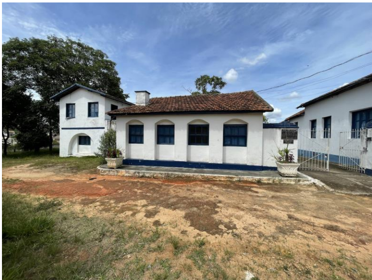
FOTO 07: Fachada frontal edificação paralela à Casa Sede. Bom estado de conservação, salvo alguns pontos com desprendimento de camada pictórica e respingos de tinta no embasamento. Telhamento bastante desgastado em virtude de agentes climáticos e do tempo.
