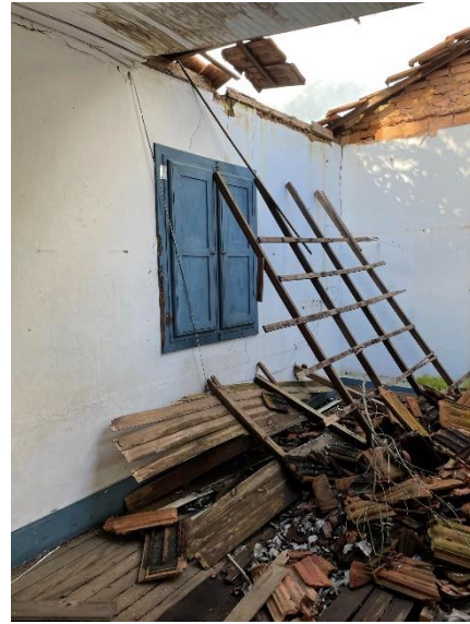
Figura 15: Ambiente interno da Casa Sede, com foco para o forro, que apresenta as seguintes patologias: sujidades, envergadura, fendilhamento e peças faltantes devido seu desprendimento das demais.
