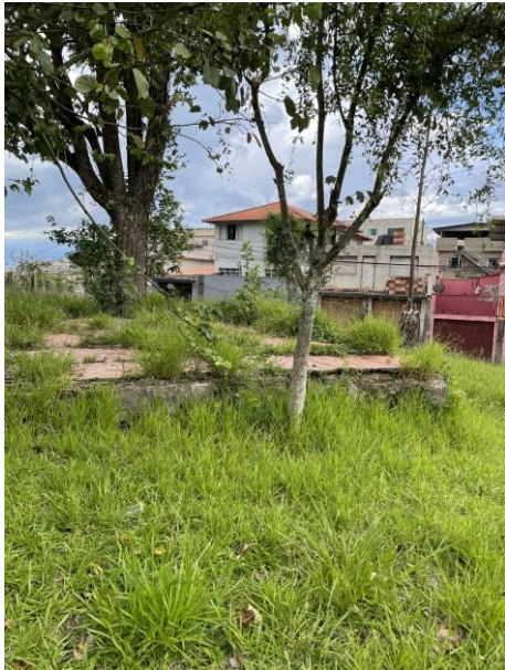
FOTO 06: Antigo abrigo de animais sendo, posteriormente, sala de aula. Erosão de todo e embasamento, com vegetação crescente em toda a área.
