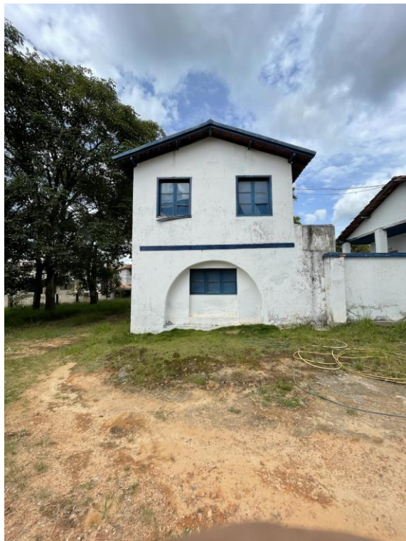
FOTO 10: Fachada frontal salões de oficinas. Depósitos escuros no guarda-corpo da escada. Desprendimento da camada pictórica em toda a superfície. Esquadria solta e com vidros faltantes, além de trincas pontuais.
