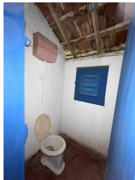
FOTO 27 : Ambiente 11 da Casa Sede. Inexistência de forro com vista direta do telhado. Paredes com desprendimento de camada pictórica, sujidades e trinca a partir da esquadria, ramificada verticalmente no encontro de duas paredes.
