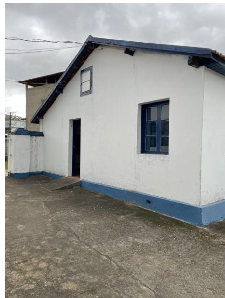
FOTO 08: Fachada lateral direita edificação paralela à Casa Sede. Sujidades e desprendimento da camada pictórica em grande parte da superfície..
