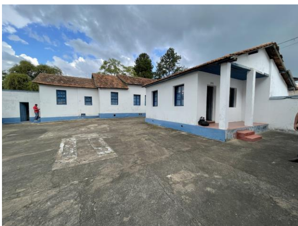
FOTO 09: Fachadas posterior e lateral esquerda edificação paralela à Casa Sede. Desprendimento da camada pictórica e depósitos escuros concentrados na parte inferior das faces.
