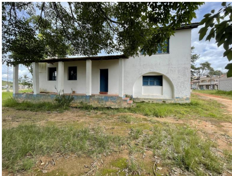
FOTO 11: Fachada lateral esquerda salões de oficinas. Desprendimento da camada pictórica de maneira ascendente, desde o embasamento, o qual possui lacunas, decorrentes da ação de agentes climáticos. Ainda no embasamento, é possível observar trincas preenchidas em alguns pontos por vegetação. Os pilares de sustentação do telhado se encontram em recalque.
